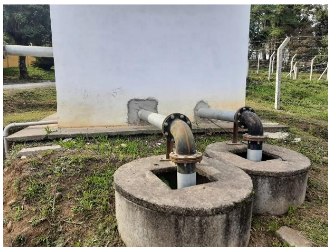
Figura 5: Poços de bomba da captação
