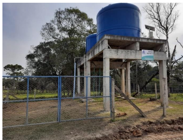
Figura 11: Reservatórios R2 e R3
