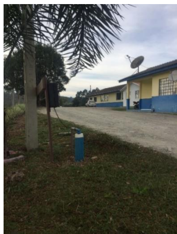
Figura 17: Poço semi artesiano – Escola Dráusio Celestino da Cunha, Rio Claro.
