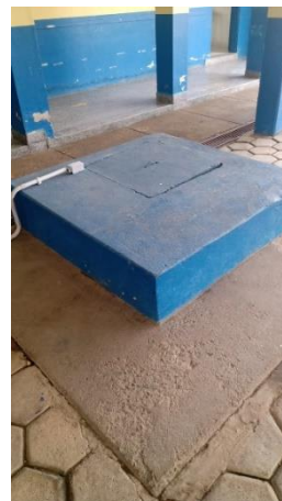
Figura 16: Poço comum – Escola Frei André Malinski, Rio Novo.
