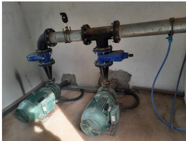
Figura 7: Bombas da ERAB – 30 CV
