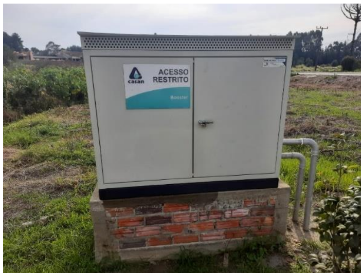
Figura 12: Booster – Bomba 2 CV
