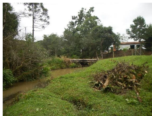
Figura 18. Ponte estreita no Rio Novo, com muitos restos orgânicos acumulados impedindo a passagem correta das águas no SC_MAJORVI_SR_10_CPRM.
