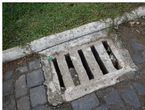
Figura 20. Boca-de-leão assoreada, impedindo o correto funcionamento de escoamento das águas superficiais.
