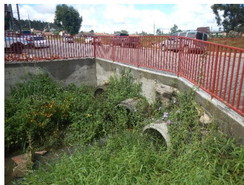
Figura 12. Detalhe para a travessia do Rio Major Vieira (Monjolo). Caso alguma obstrução ocorra na tubulação a inundação será potencializada.
