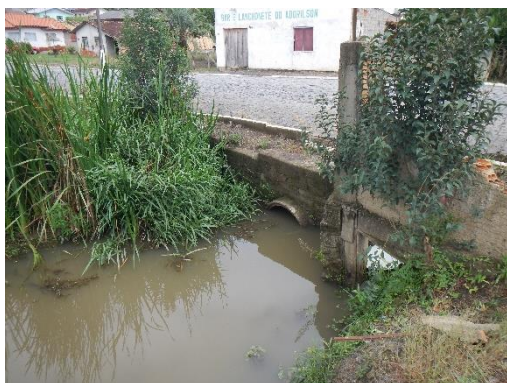
Figura 11. Travessia do rio Major Vieira (Monjolo) sob rua prejudicada por subdimensionamento e assoreamento.
