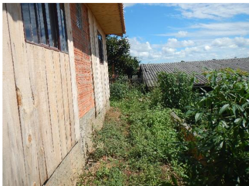
Figura 7. Moradia de madeira sobre aterro mal compactado, próximo a crista. O aterro está escorado em um muro de divisa que já apresenta sinais de movimentação (trincas). SC_MAJORVI_SR_3_CPRM.
