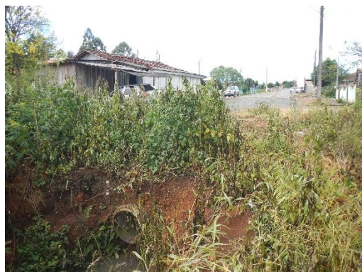
Figura 19. Lançamento de águas pluviais diretamente no solo, sem proteção, provocando erosão do solo.
