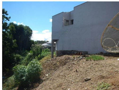
Figura 8. Moradia de alvenaria construída próxima à crista da encosta. Fissuras e trincas se apresentam como evidências de provável movimentação do terreno de apoio, assim como da fragilidade construtiva da moradia.
